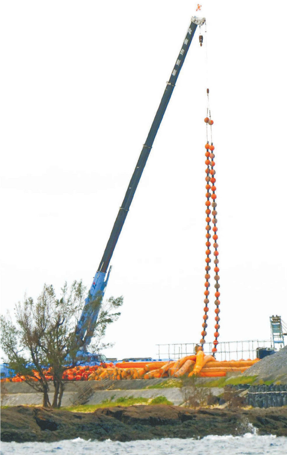
辺野古新基地建設の土砂投入に向けて、浮具(フロート)をつり下げる重機=1日午前9時14分、名護市辺野古
